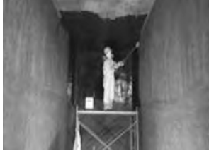
나운배수지 보수 (보수중)
