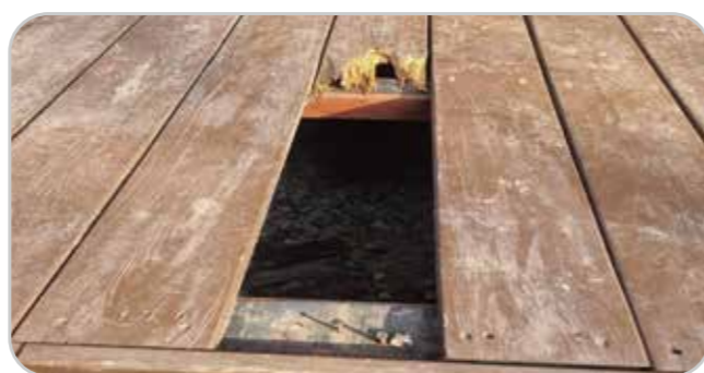
행사장 시설 파손
