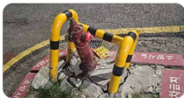
소화 시설 파손
