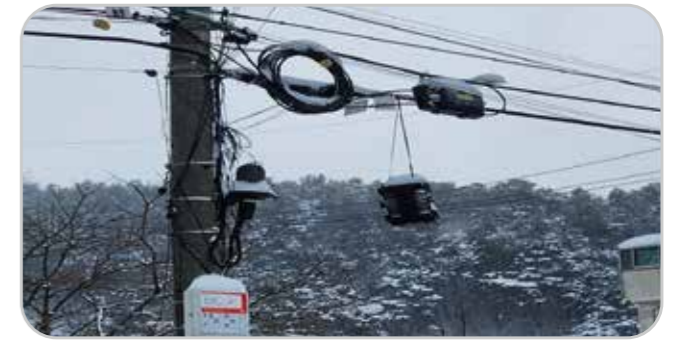
시설물 파손 낙하 위험
