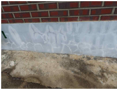
① 외부 지중보 균열, 백태
