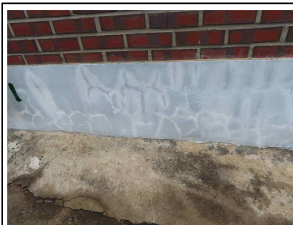
외부 지중보 균열, 백태
