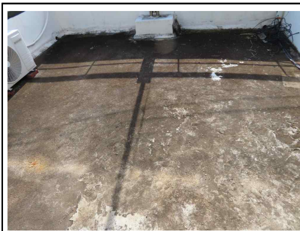
지상2층 바닥 방수보호몰탈 열화
