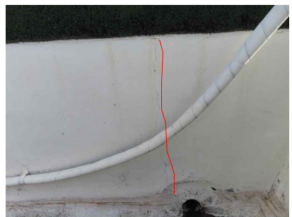
⑨ 파라펫 균열
