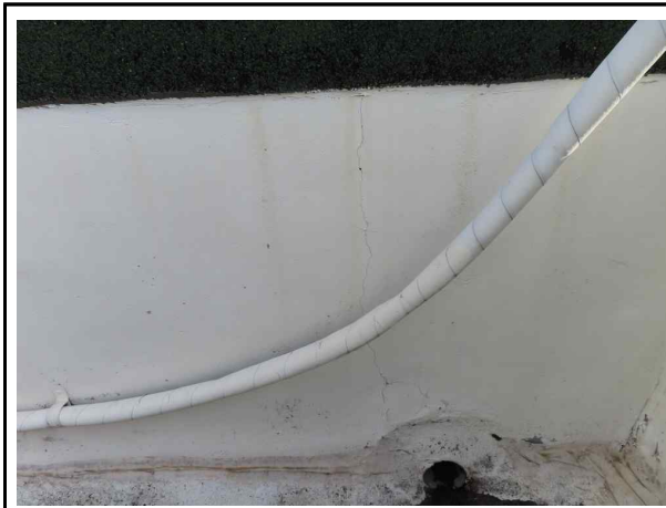
지상2층 파라펫 균열
