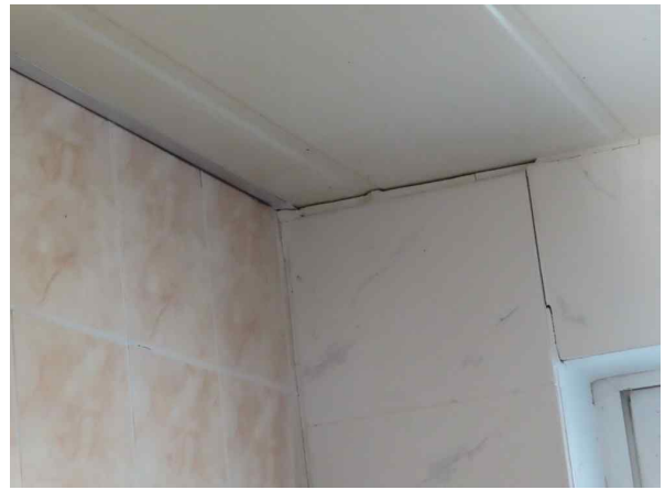
지상2층 벽체 타일 파손
