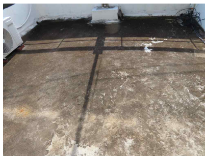
⑧ 바닥 방수보호몰탈 열화
