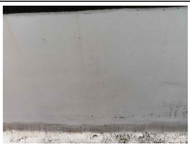
지상2층 파라펫 균열
