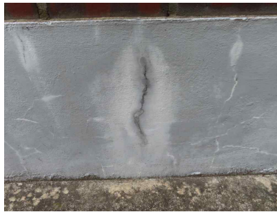
② 외부 지중보 균열, 백태
