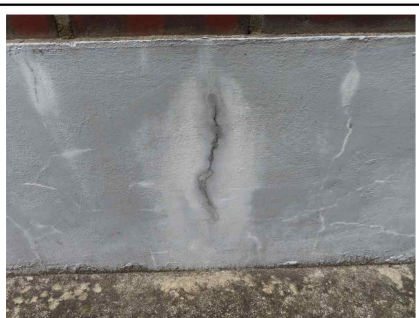
외부 지중보 균열, 백태
