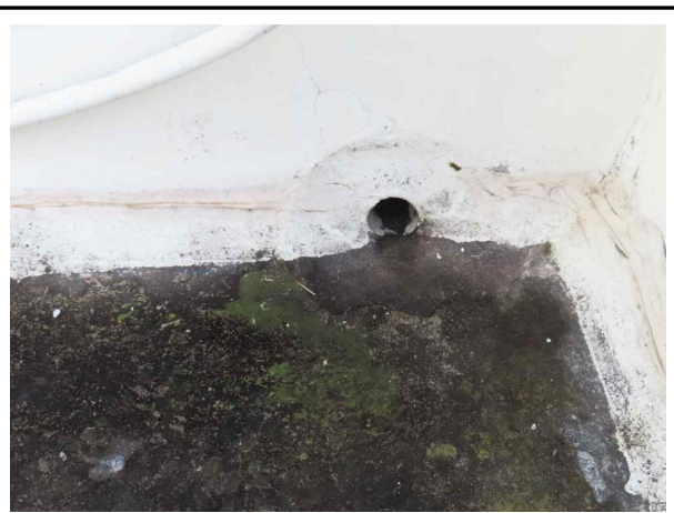
지상2층 배수구 상태양호
